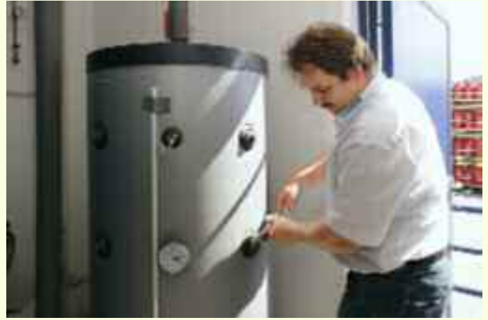
Installateur Sönke Jensen prüft die Funktion des Pufferspeichers der Anlage. (Fotos: PROGAS)
